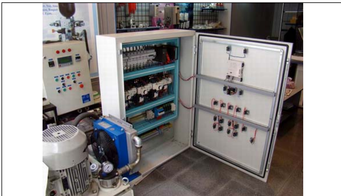
تابلوی برق PLC مربوط به دستگاه تست خستگی مخازن CNG (به سفارش شرکت مخازن تحت فشار کاوش)
